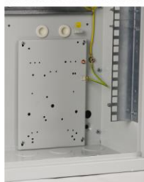
Pusta blacha montażowa
